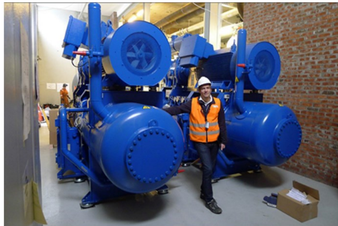
Bruker avløpsvann som kilde til 3 MW varmepumpe
